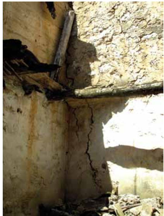
En el transcurso de cuatro años de abandono las grietas se hacen más pronunciadas (2006-2010)
