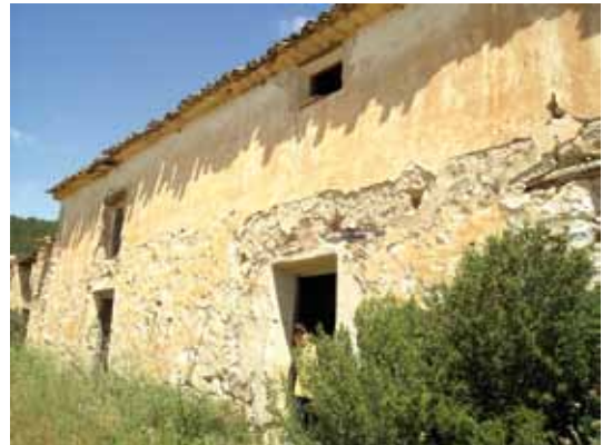
Puede verse la línea que separa las dos tipologías constructivas en el muro, por el desconchamiento del mortero en la parte construida con piedra
