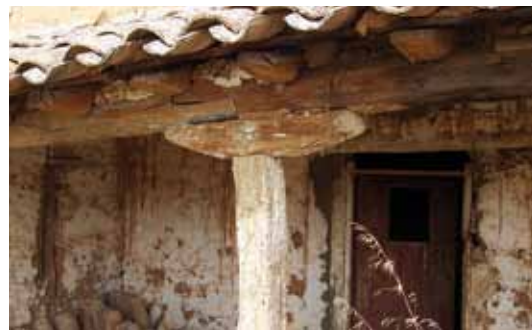
Detalle de junta entre durmientes. Soportal. Casa de D a Melitona Meneses. Término de Casasimarro. Casa de labor cercana al río Júcar
